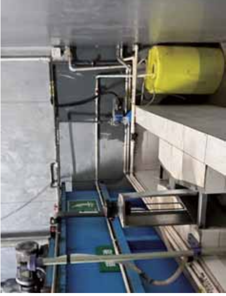
项目生产废水排放口
